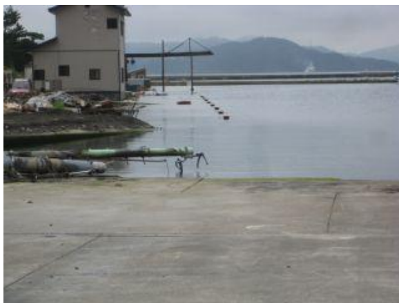
図-6 寺間漁港の沈下状況
